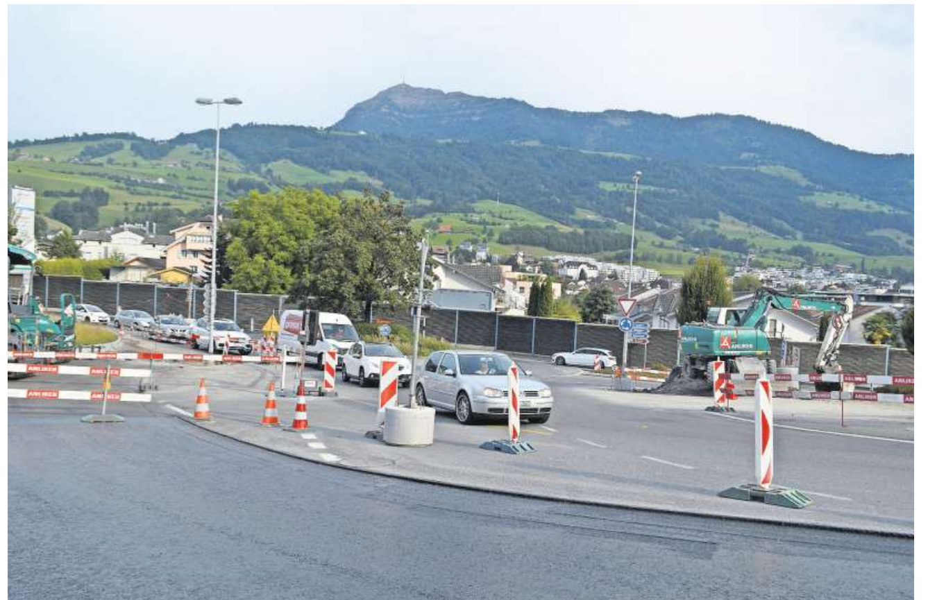
Der Bereich des Bär-Kreisels bleibt die nächsten 15 Wochen eine Baustelle mit Verkehrsbehinderungen. Bild: Silvia Camenzind
