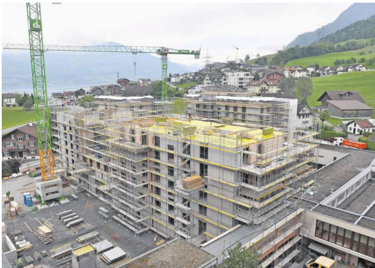
Der sich nun im Bau befindende erste Teil rund um den künftigen Bethlehemhof – bisher Glaushof – bildet den Kern der Wohnsiedlung und integriert so einen Teil der heute bestehenden Gebäudestruktur. Bilder: Edith Meyer
